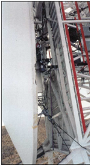
Subreflector Edge Damage
